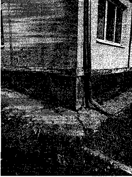
Фото 1-3. Отмостка. Повреждение отмостки. Наличие растительного слоя на отмостке
